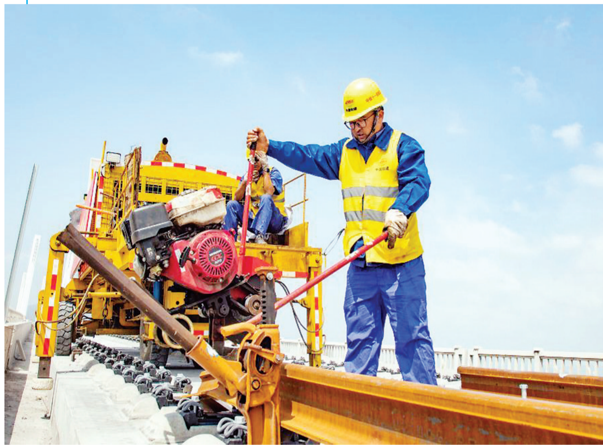
4月15日，工人在新建福州鐵路湄洲灣跨海大橋鋪軌。當日，由中鐵十一局承建的新建福州鐵路湄洲灣跨海大橋順利鋪軌，為新建福州鐵路早日建成通車奠定基礎。（周義 來源：新華社）
